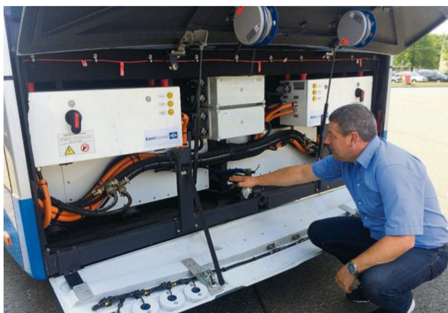
Hightech im Heck: In den Hochleistung-Akkus speichert der Solinger Batterieobus BOB die während der Fahrt gewonnene Energie aus der Oberleitung, um sie für den Elektroantrieb außerhalb des Fahrdratnetzes einzusetzen. Foto: Krummbeuer
